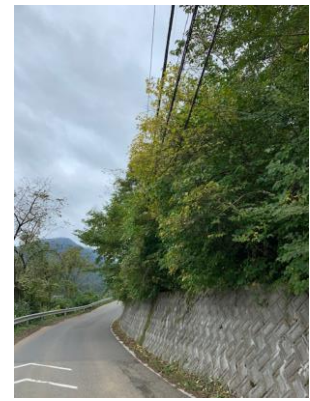
市道殿上線（前） 雑木が電線にかかる
