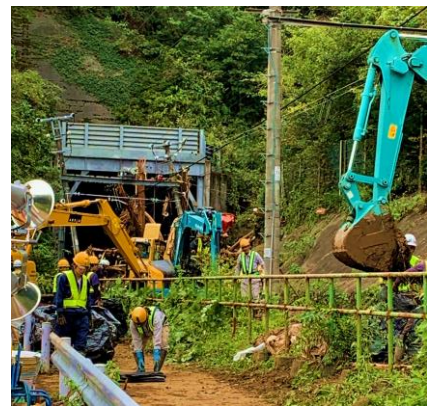
J R 梁川地内線路内に土砂崩落
