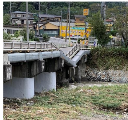
国道 20 号初狩地内橋崩落の恐れ
